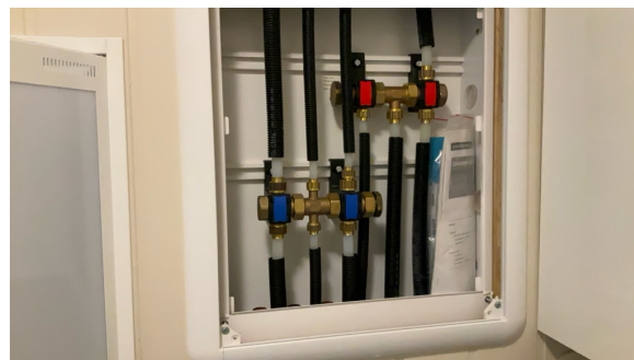
Kurser for rør-i-rør opplegg er ikke merket.
