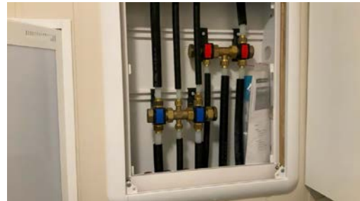
Kurser for rør-i-rør opplegg er ikke merket.
