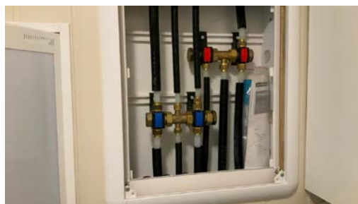
Kurser for rør-i-rør opplegg er ikke merket.
