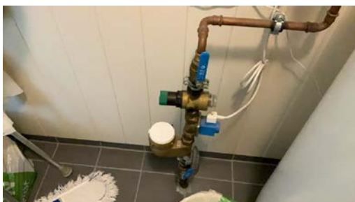
Innvendig hovedstøpkekran og vannmåler er plassert i teknisk rom.
