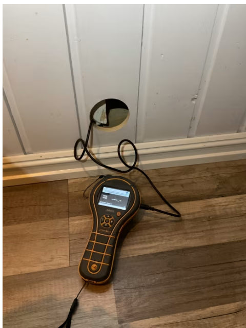
Fuktmåling i tilstøtende vegg.
