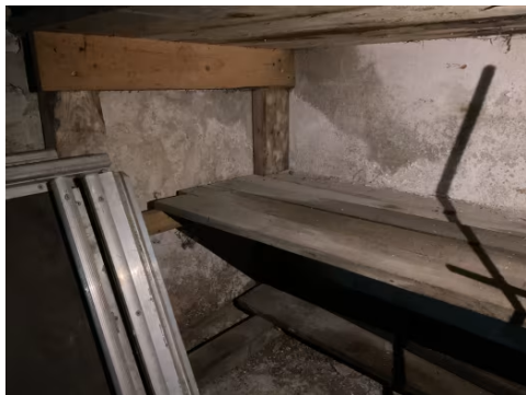
Saltutslag på vegger i tidligere garasje.
