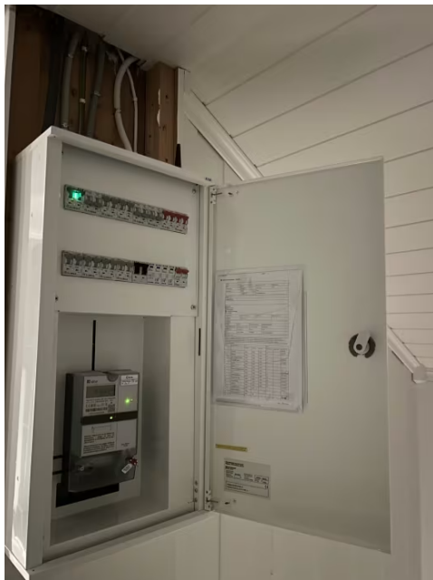
Sikringsskap i gang 2. etg
