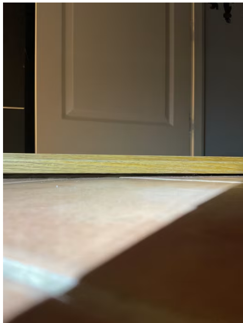
Manglende tetteslikt ved dør.
