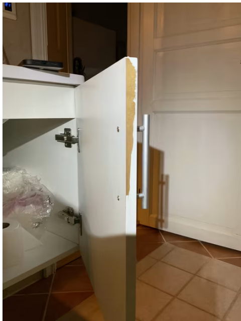
Skade på innredning.
