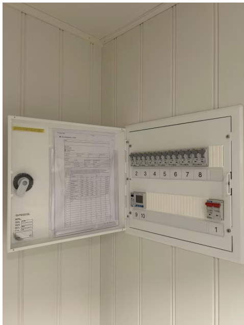
Sikringsskap i gang kjeller.
