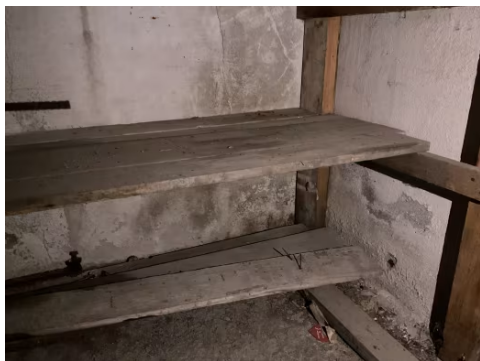
Saltutslag på vegger i tidligere garasje.
