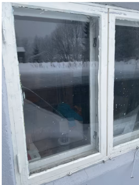
Vindu i kjeller fra byggeår med sprekk.
