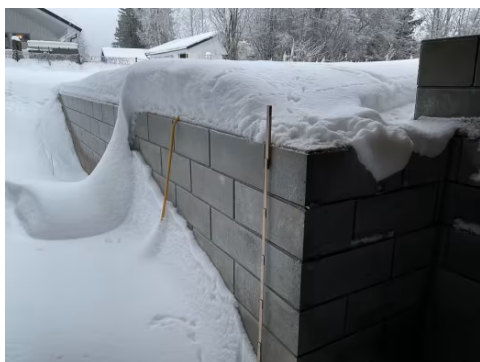
Manglende rekkverk på støttemur.
