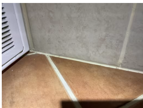
Sprekk i fuge.
