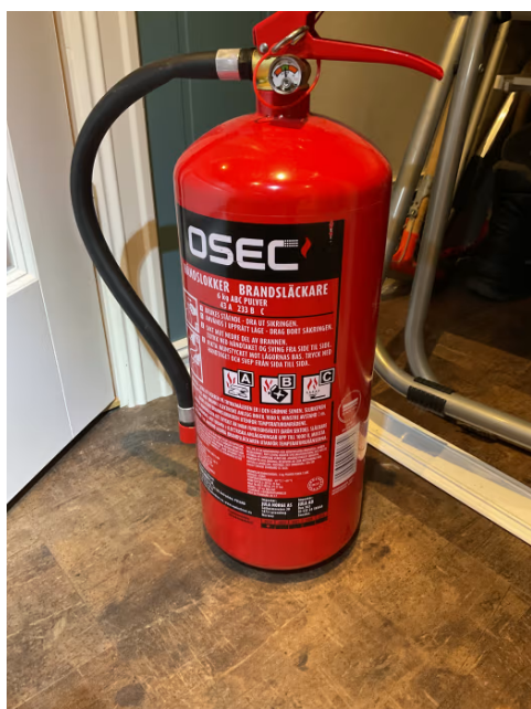
Brannslukker plassert i gang 1. etg
