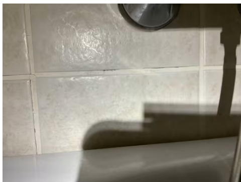
Sprekk i fuge på vegg.
