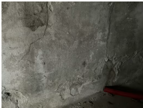
Riss/sprekker i grunnmur.
