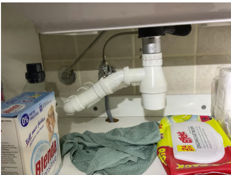
Avløpsrør bad 2. etg
