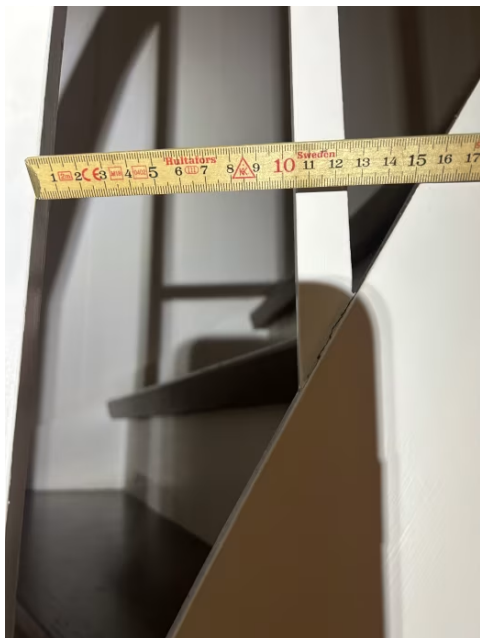
For stor avstand mellom rekkverkspiler.
