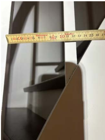
For stor avstand mellom rekkverkspiler.
