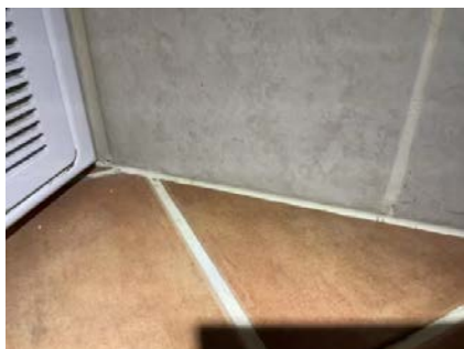
Sprekk i fuger.
