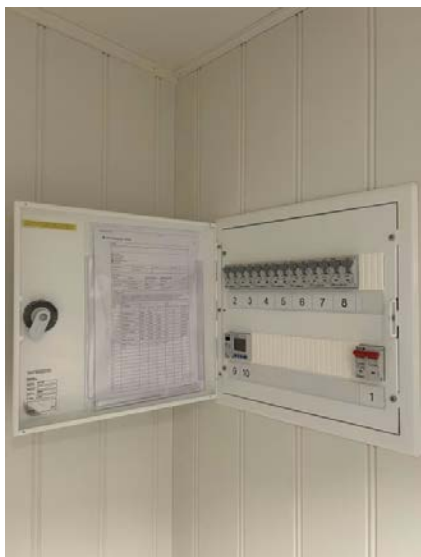
Sikringsskap i gang kjeller.
