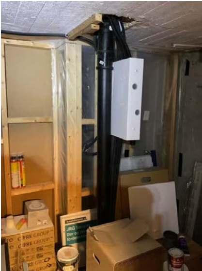
Avløpsstamme i uferdig bad kjeller.
