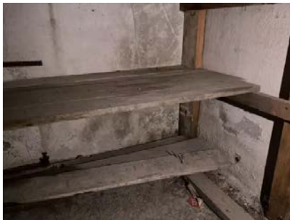
Saltutslag på vegger i tidligere garasje.
