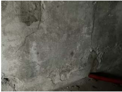
Riss/sprekker i grunnmur.
