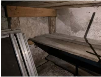
Saltutslag på vegger i tidligere garasje.
