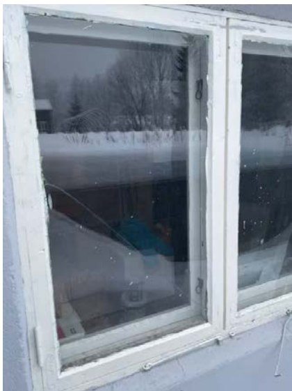
Vindu i kjeller fra byggeår med sprekk.
