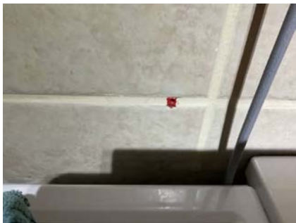
Plugger i fug over innredning.
