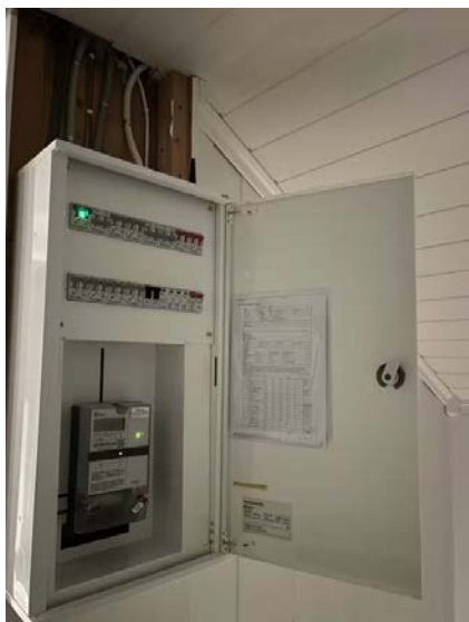
Sikringsskap i gang 2. etg
