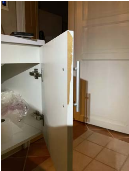
Skade på innredning.
