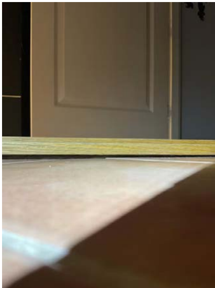
Manglende tetteslikt ved dør.
