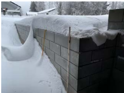
Manglende rekkverk på støttemur.
