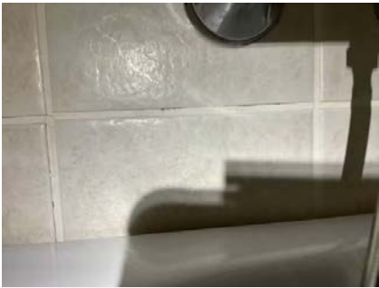
Sprekk i fuge på vegg.
