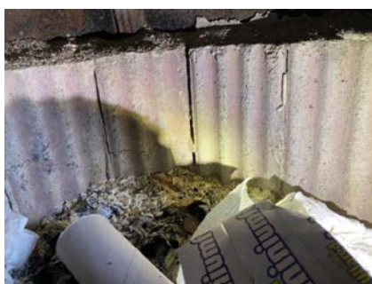
Det er påvist sprekker i ildfast stein inne i ovnen.
