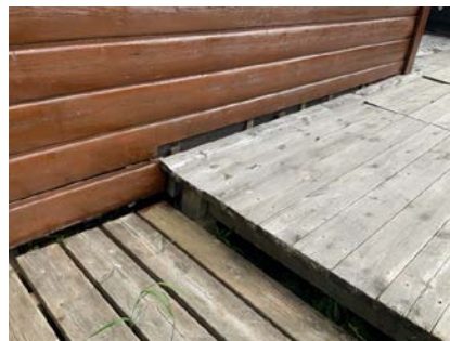
Manglende bordkledning, samt glippe mellom bord. Manglende musebånd.
