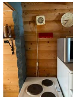
Avtrekksvifte ut i vegg er defekt.
