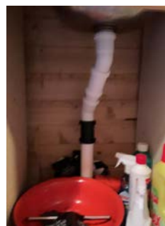
Avløpsrør fra utslagsvask på WC.
