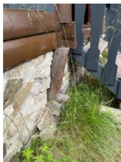
Store skjevheter i søylepunkt mot øst.
