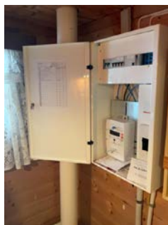
E>l-skap med automatsikringer plassert inne på wc-rom.
