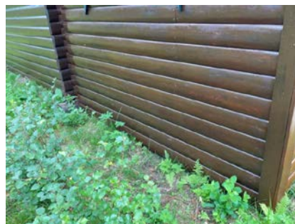
Bordkledning/tømmer ført ned mot mark.
