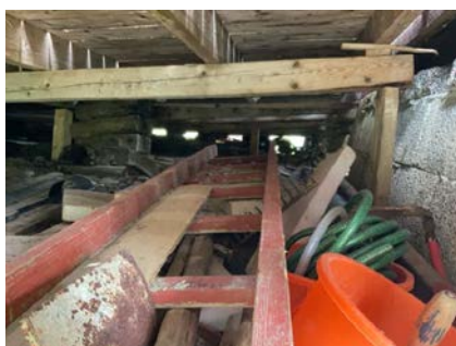
krypkjeller, inspisert fra sør side av bygget.
