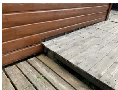
Manglende bordkledning, samt glippe mellom bord. Manglende musebånd.
