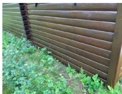
Bordkledning/tømmer ført ned mot mark.
