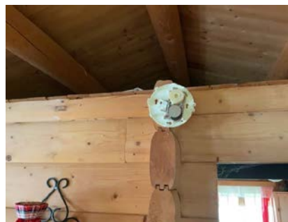
Røykvarsler av eldre type, mangler batteri/løst deksel.
