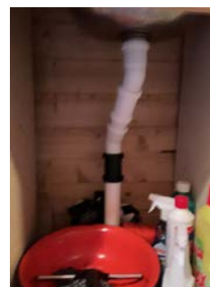
Avløpsrør fra utslagsvask på WC.
