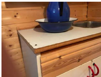
Skader i benkeplate samt manglende laminering i front/kant på plate.
