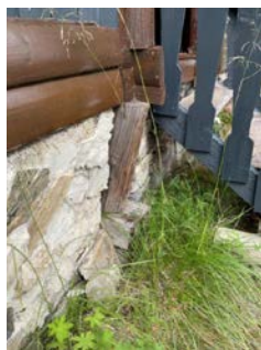
Store skjevheter i søylepunkt mot øst.
