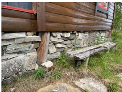
Store skjevheter i søylepunkt mot øst.
