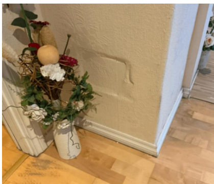
Foto viser overdekket sotluke i gang 1.etg
