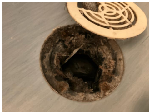
Foto viser sluk på bad 1.etg
