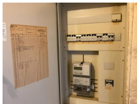
Foto av sikringskap
