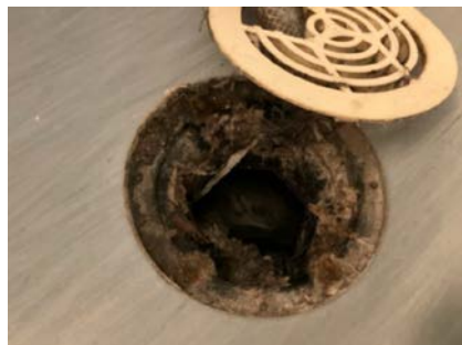
Foto viser sluk på bad 1.etg
