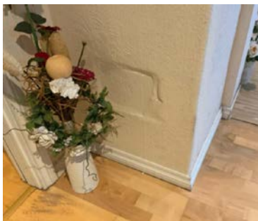
Foto vise overdekket sotluke i gang 1.etg
