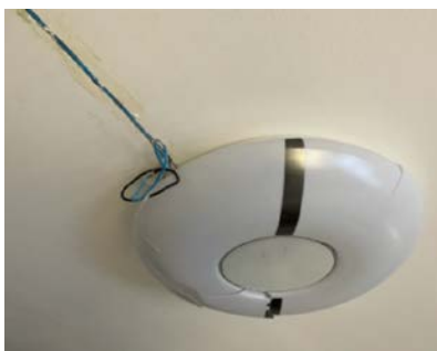
Taklampe på soverom i 2.etg framstår opplagt ufagmessig montert.
