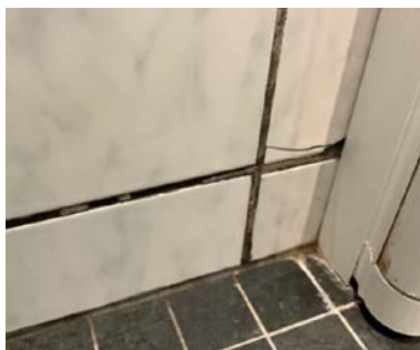
Foto viser sprekkdannelse med fuktskade i vegg
