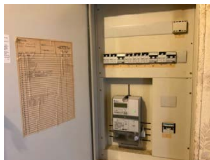
Foto av sikringskap
