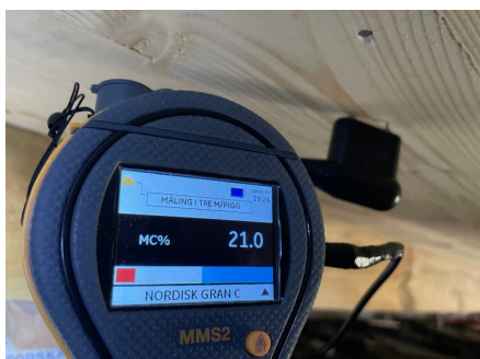
Fuktmåling - Noe høyt trefuktinnhold i skillekonstruksjonen mot kryprommet.
