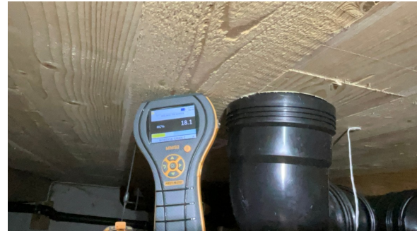
Fuktmåling fra krypromssiden - Noe høyt trefukttinnhold i skillekonstruksjonen.
