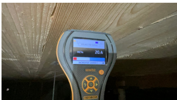
Fuktmåling - Noe høyt trefuktinnhold i skillekonstruksjonen mot kryprommet.
