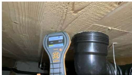
Fuktmåling fra krypromssiden - Noe høyt trefukttinnhold i skillekonstruksjonen.
