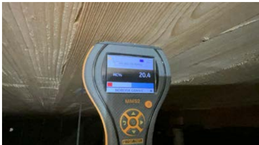
Fuktmåling - Noe høyt trefuktinnhold i skillekonstruksjonen mot kryprommet.
