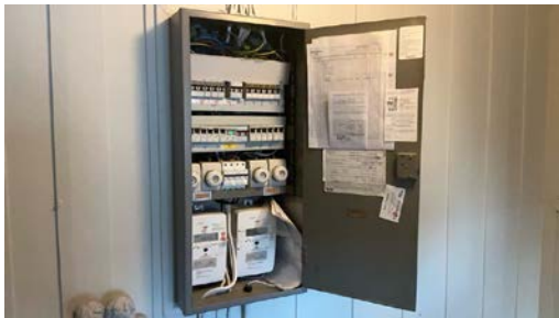
Sikringsskap i felles trappeoppgang.
