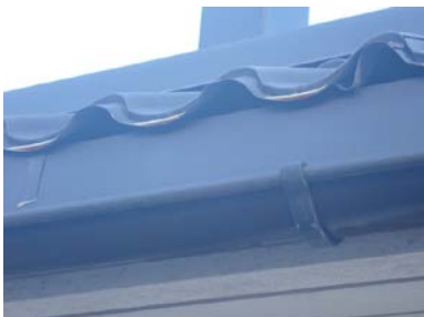
Løs folie / rust i takplater
