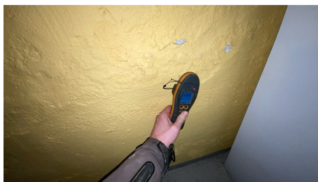
Saltutslag og forhøyning ved fuktsøk vegg åpen mur
