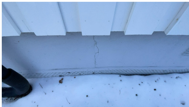
Sprekk ved utkraget mur/leveg for stueterrasse
