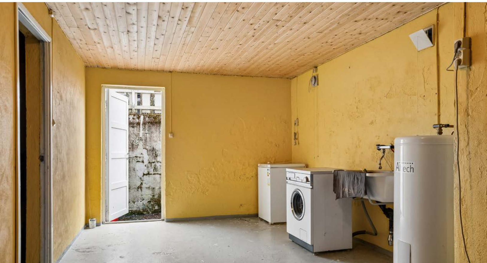
Vaskekjeller med utgang ut. Inneholder vaskekar, opplegg for vaskemaskin og 198 liter VV bereder fra 2007.
