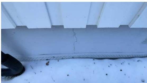
Sprekk ved utkraget mur/leveg for stueterasse
