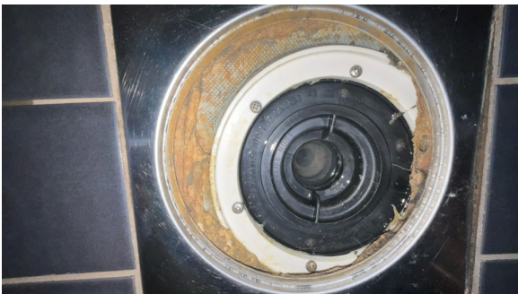
Forskyvning mellom sluk og slukrist.
