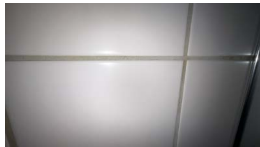
Noe misfargede fuger i våtsone og mindre riss i enkelte flisfuger ved glassdør.
