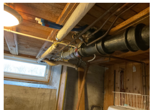
Avløpsrør av plast og støpejern i kjellerboden
