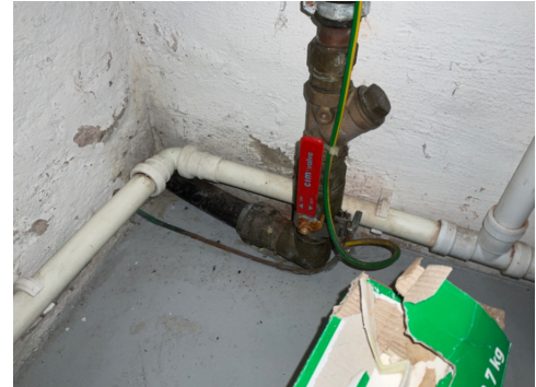
Hovedstoppekran til bygningen i felles vaskerom
