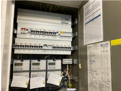
Sikringskapp i felles trappeoppgang
