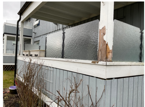
Malings avflassing på søyler
