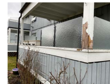
Malings avflassing på søyler
