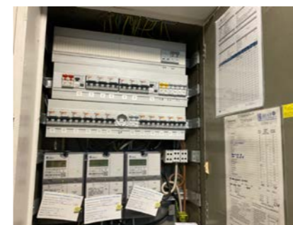
Sikringskap i felles trappeoppgang
