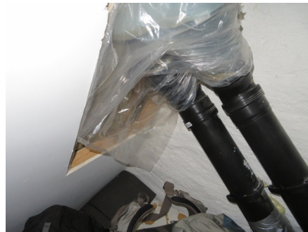
Uferdig avslutning for gjennomføring av avløps-rør.
