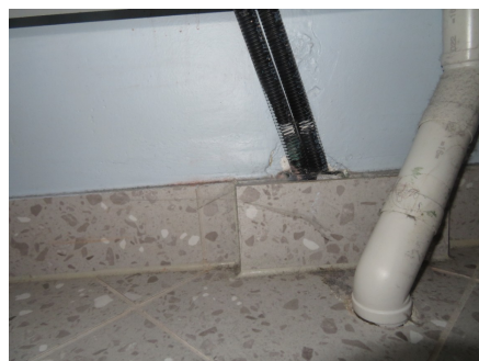
Vannrør ført opp av gulvet. Ender er ikke tettet.
