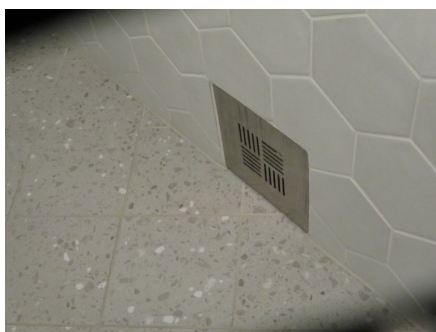
Inspeksjons-luke i badekar-front, er fuget fast.
