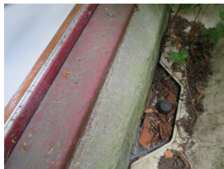
Det er murt opp på vinduskarm på kjellervinduer. Feil utførelse.
