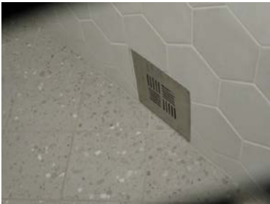
Inspeksjons-luke i badekar-front, er fuget fast.
