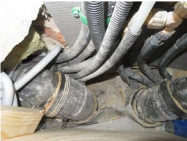
Rom inne i innkassing i kjeller ser ikke ut til å være lekkasje/vann-sikret.
