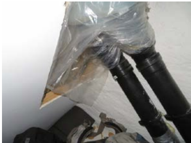
Uferdig avslutning for gjennomføring av avløps-rør.
