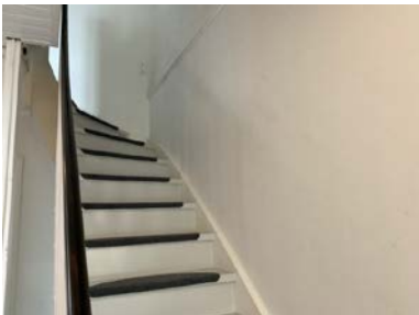
Trapp til loft. Manglende håndløper på vegg.
