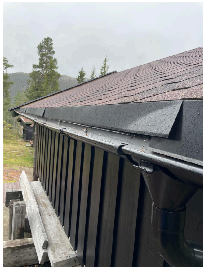
Store skjevheter i takrennen, tak vannet vil ikke nå nedløp.
