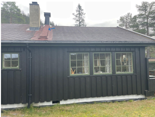
Lufte lyre for å øke kapasiteten på lufting.
