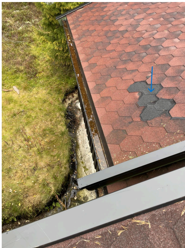
Lukket skade etter vindfall.
