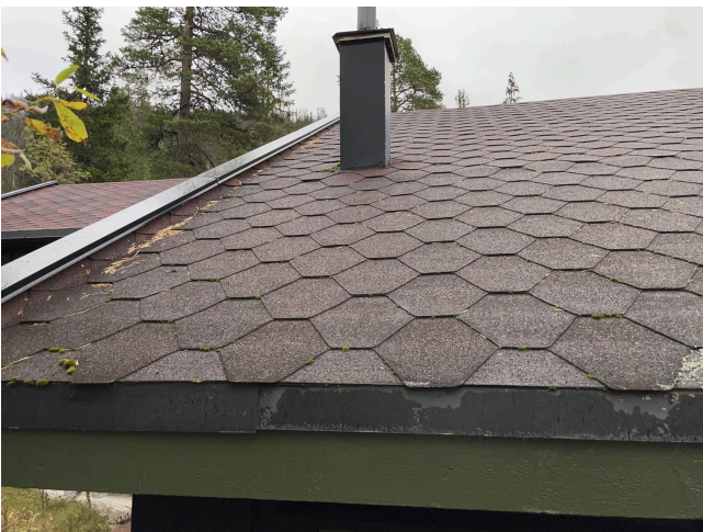
Det mangler takrenne og nedløp.
