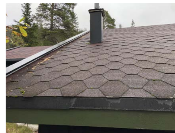
Det mangler takrenne og nedløp.
