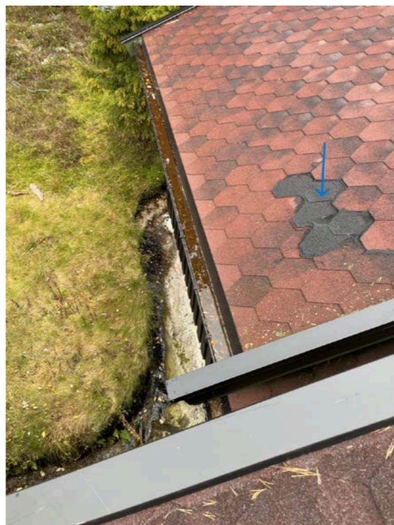
Lukket skade etter vindfall.
