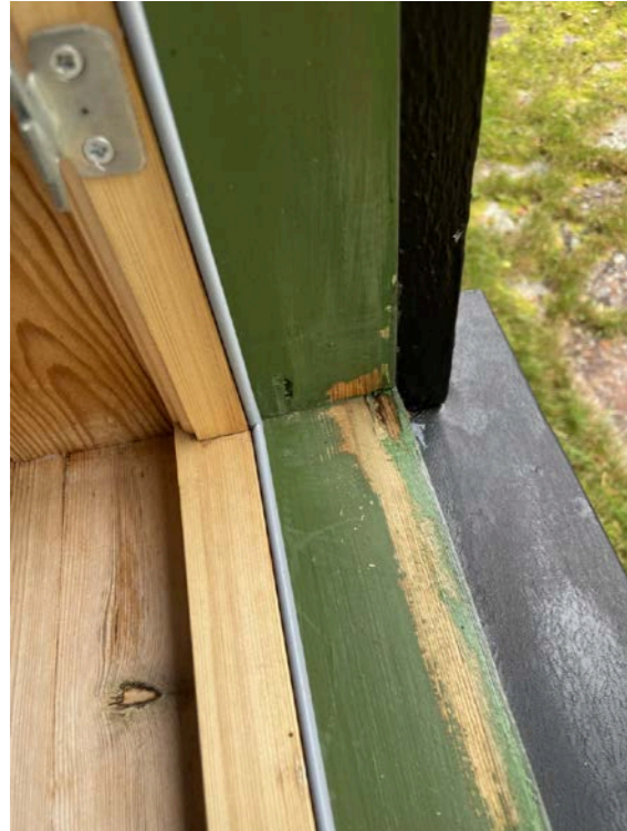
Vindusramme på kjøkken har begynnende råte i hjørne.
