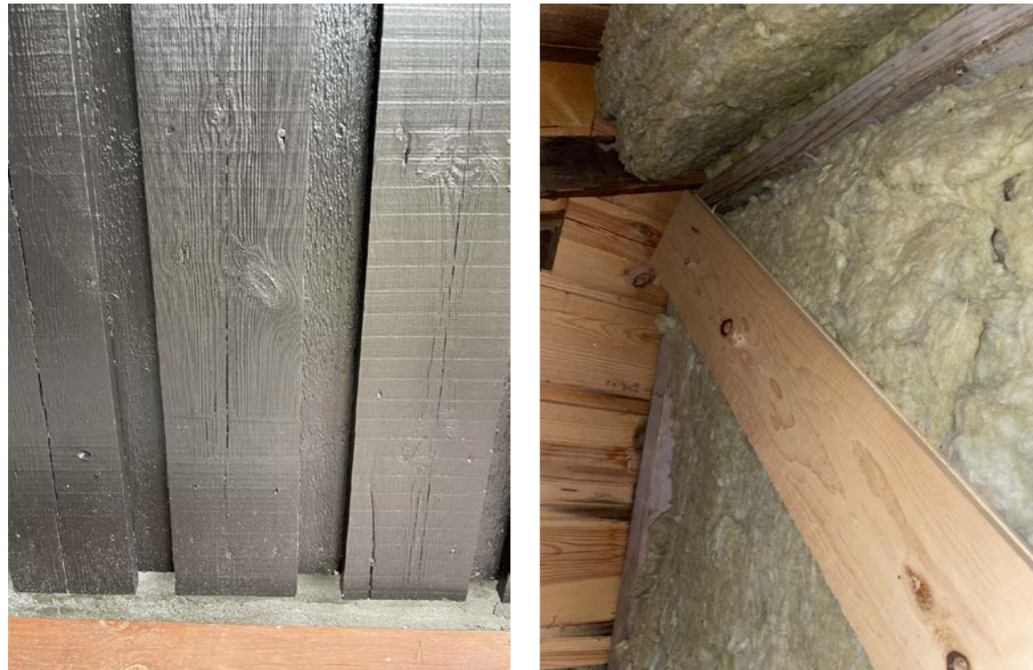
Det mangler vind sperre på knevegg på kaldloft.
