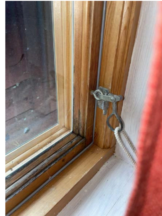
Merker i vindusramme som er en konsekvens av luftfuktighet og temperatur .
