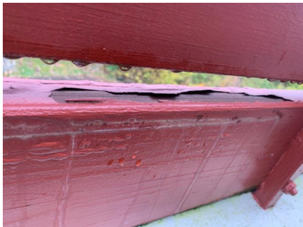
Etterslep av vedlikehold
