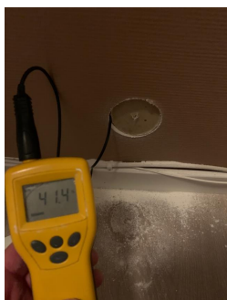
Ingen fukt måkt i vegg ved hulltaking
