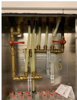
Rørskap. Stoppekraner fungerer som tiltenkt
