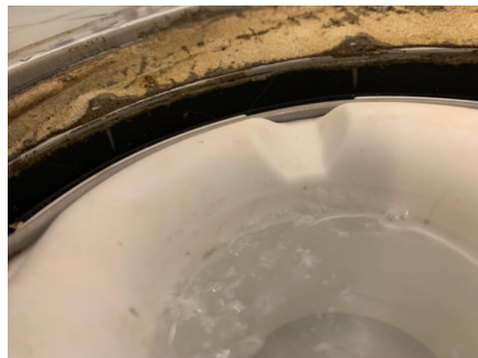
Synlig slukmansjett e.l. klemt i slukets klemring
