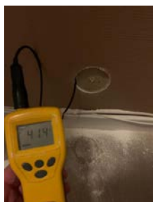
Ingen fukt måkt i vegg ved hulltaking
