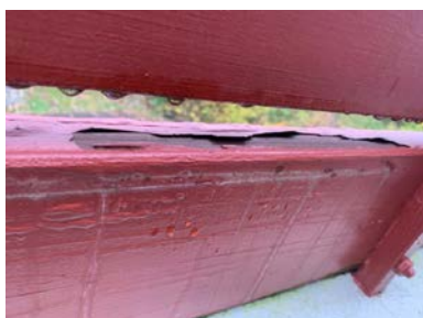
Etterslep av vedlikehold
