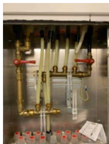
Rørskap. Stoppekraner fungerer som tiltenkt
