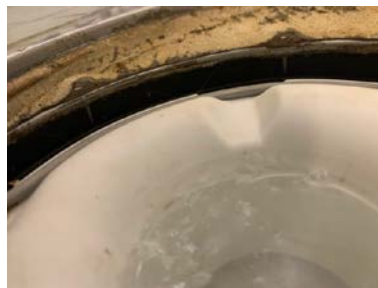
Synlig slukmansjett e.l. klemt i slukets klemring
