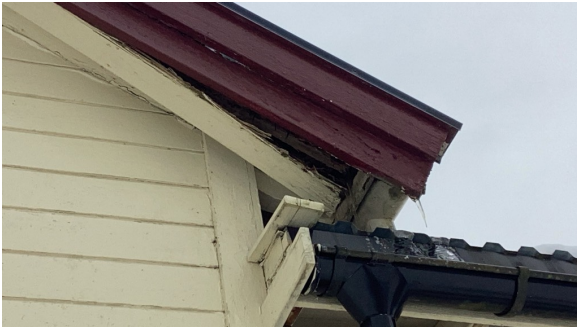
Råte i sperre på utsiden på hjørne mot nord-vest.
