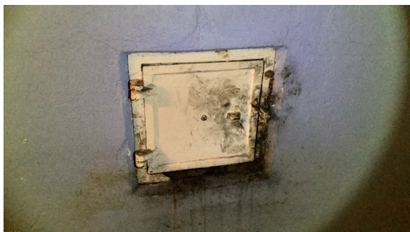
Sotluke i kjeller.
