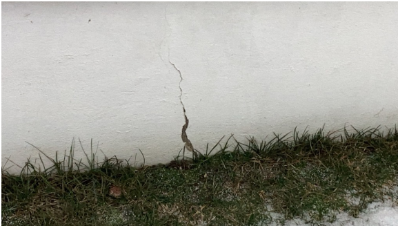
Eksempel på sprekk i grunnmur.
