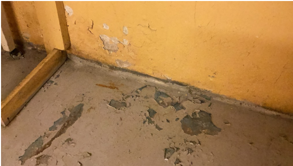
Eksempel på avskaling på gulv.
