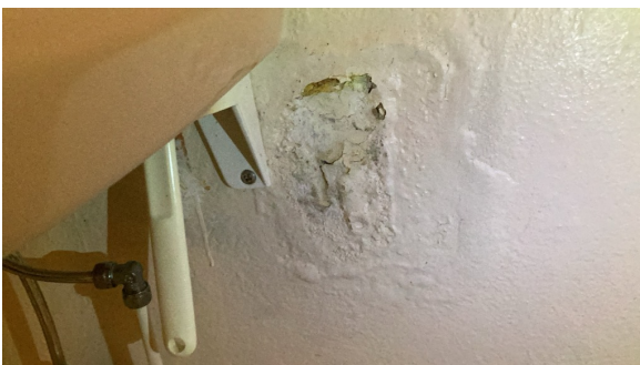
Eksempel på avskaling på vegg.
