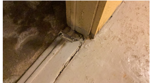
Råte i terskel i kjeller.
