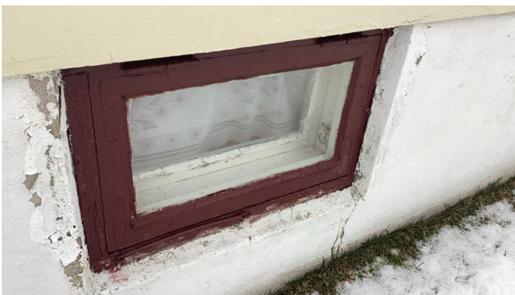
Vinduer med enkle glass og varerammer har slitasje og oppsprekking i i kitt.
