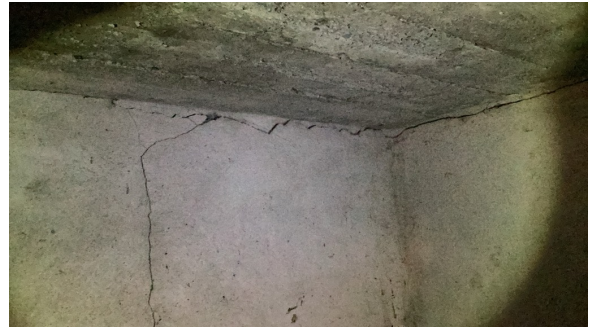
Eksempel på sprekk i grunnmur.
