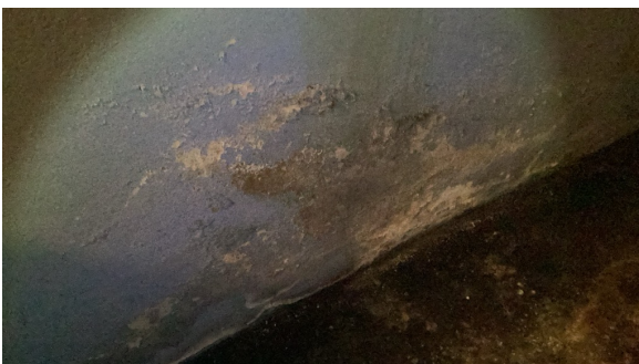
Eksempel på avskaling på vegg.
