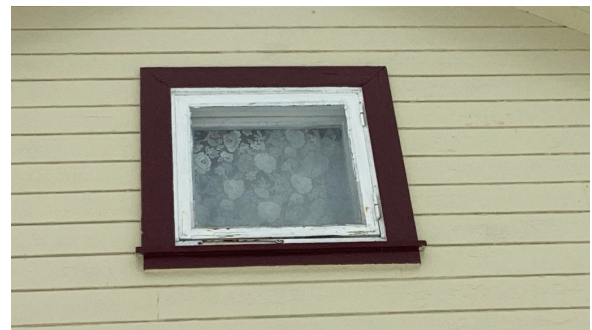
Vinduer med enkle glass og varerammer har slitasje og oppsprekking i i kitt.
