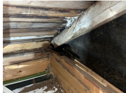
Lekkasje, fuktighet og råteskade på innsiden på hjørne mot nord-vest.
