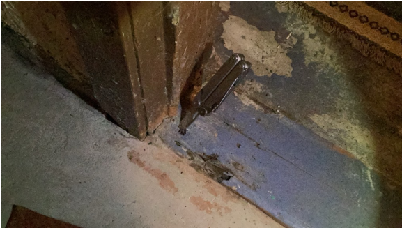
Råte i terskel i kjeller.
