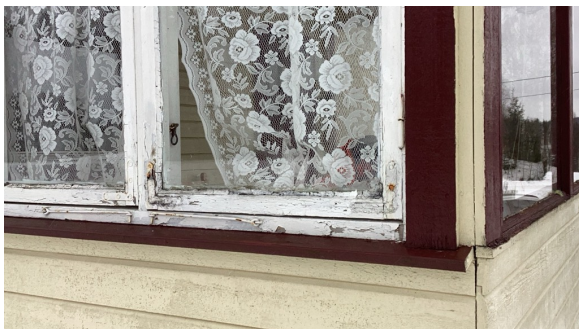
Eksempel på slitasje.
