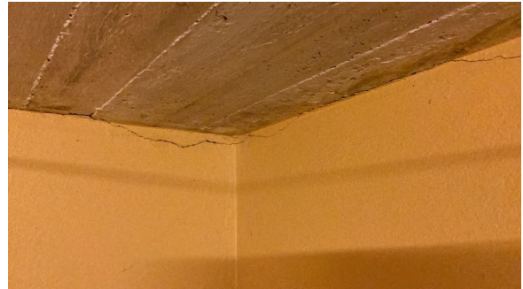
Sprekk i overgang mellom vegg og etasjeskiller.
