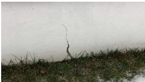
Eksempel på sprekk i grunnmur.
