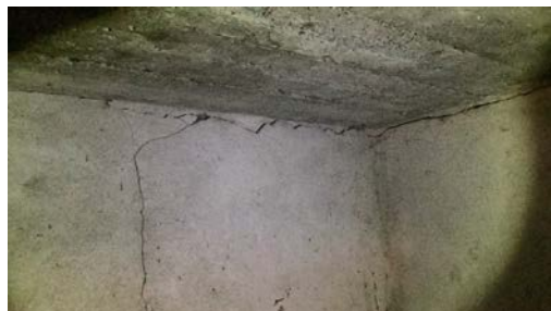
Eksempel på sprekk i grunnmur.
