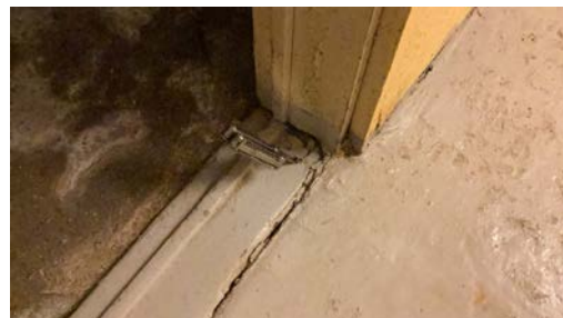
Råte i terskel i kjeller.
