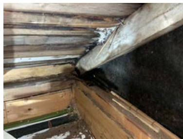
Lekkasje, fuktighet og råteskade på innsiden på hjørne mot nord-vest.
