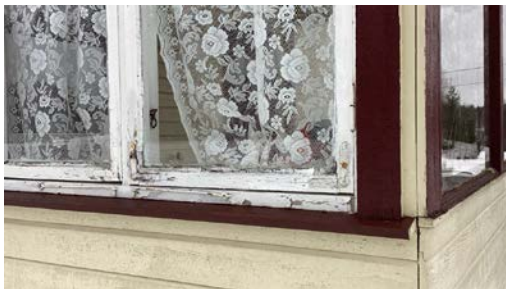
Eksempel på slitasje.
