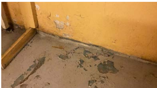
Eksempel på avskaling på gulv.
