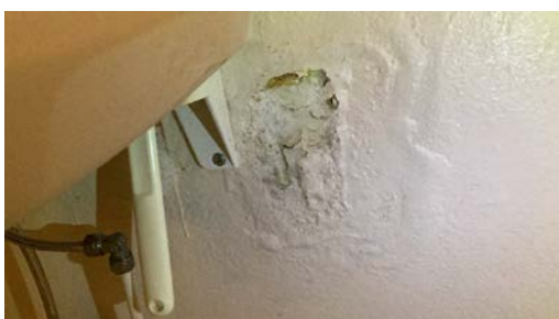
Eksempel på avskaling på vegg.
