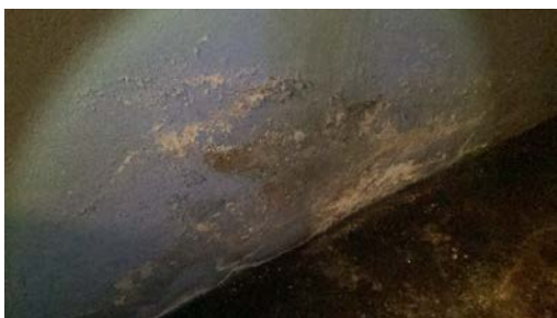
Eksempel på avskaling på vegg.
