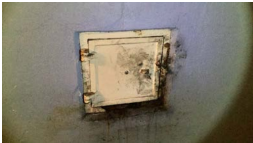
Sotluke i kjeller.
