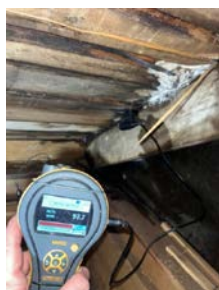
Lekkasje, fuktighet og råteskade på innsiden på hjørne mot nord-vest.
