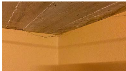
Sprekk i overgang mellom vegg og etasjeskiller.
