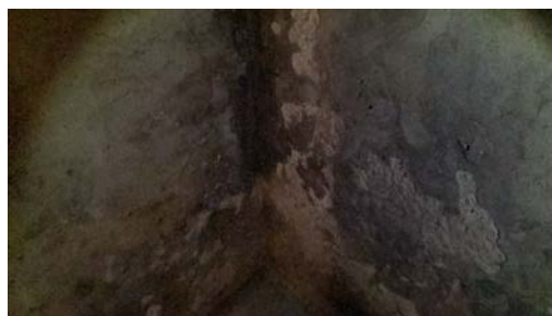
Eksempel på misfarging på vegg
