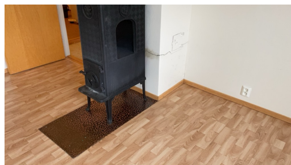
Sprekk i pipe ved sotluke i 8 M.
