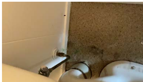
Utslag ved fuktsøk.
