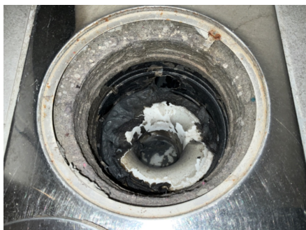
Synlig membran i sluken.
