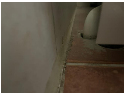
Ikke tett rundt avløp til dusjkabinett.
