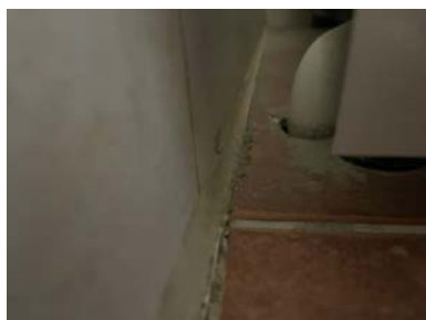
Ikke tett rundt avløp til dusjkabinett.
