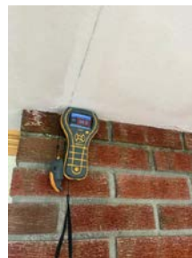
Det måles høy fukt i himling ved pipe i stue 1.etg.
