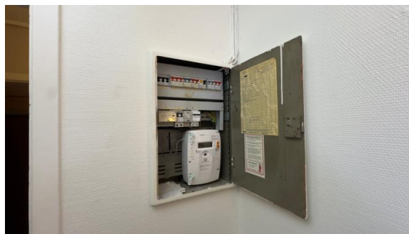
Kontroll av el-skap og kursfortegnelse.
