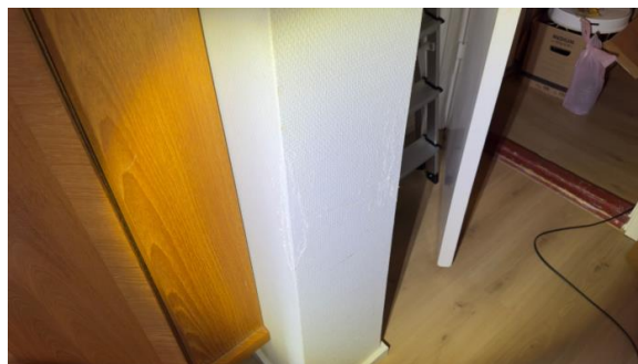
Skade/kloemerker på vegg.
