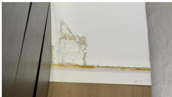
Slitasje/skade på vegg.
