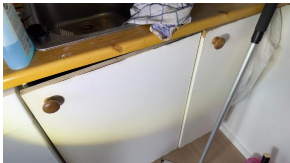
Det er registrert fuktsvell i fronter og skrog.
