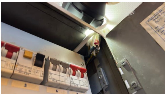
Kabelinnføringer i sikringsskap er ikke tilfredsstillende tettet. (TG3)
