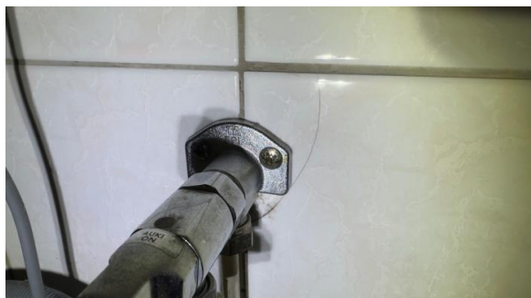
Det er registrert flis med sprekk.
