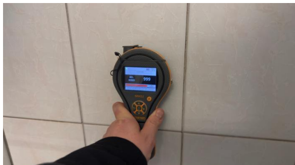
Det er registrert forhøyede fuktverdier i våtsone.
