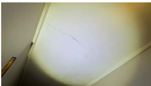
Skade i malerpapp i tak.
