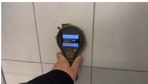
Det er registrert forhøyede fuktverdier i våtsone.
