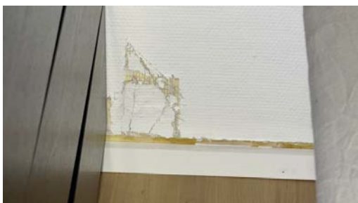
Slitasje/skade på vegg.
