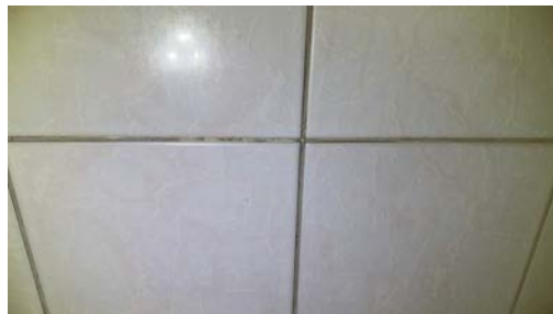
Det er registrert sprekker i flisfuger i våtsone.
