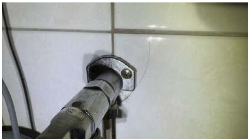
Det er registrert flis med sprekk.
