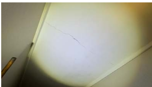
Skade i malerpapp i tak.
