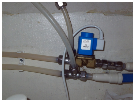
Noe av rørøpplagget i kjøkkenbenken.
