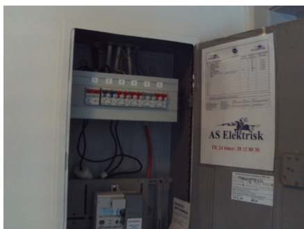
Sikringsskapet er plassert i fellesgangen.
