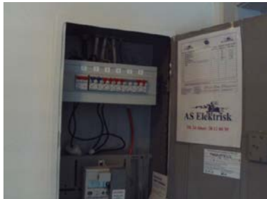
Sikringsskapet er plassert i fellesgangen.
