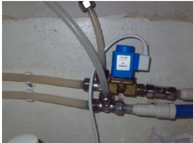
Noe av rørøppegget i kjøkkenbenken.
