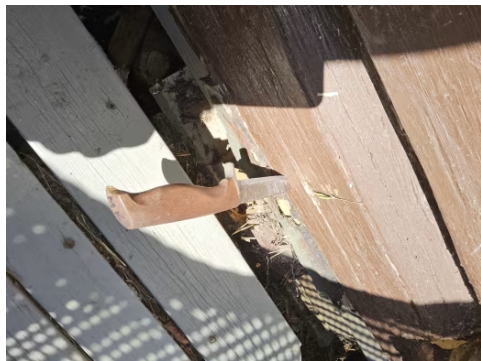
Bilde viser råteskade i bunnstokk.
