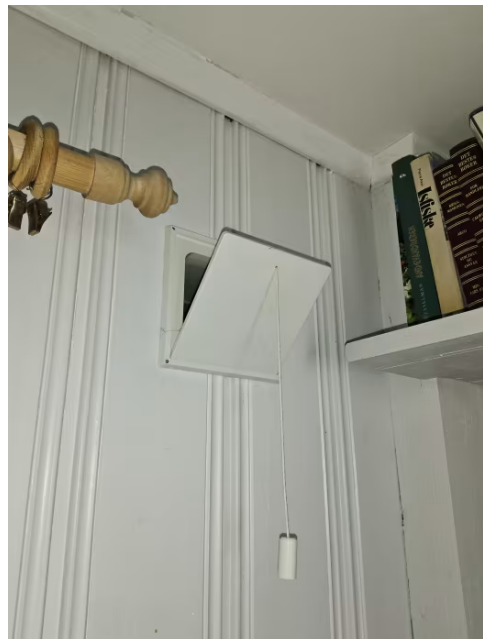
Bilde viser klaffventil på yttervegg.
