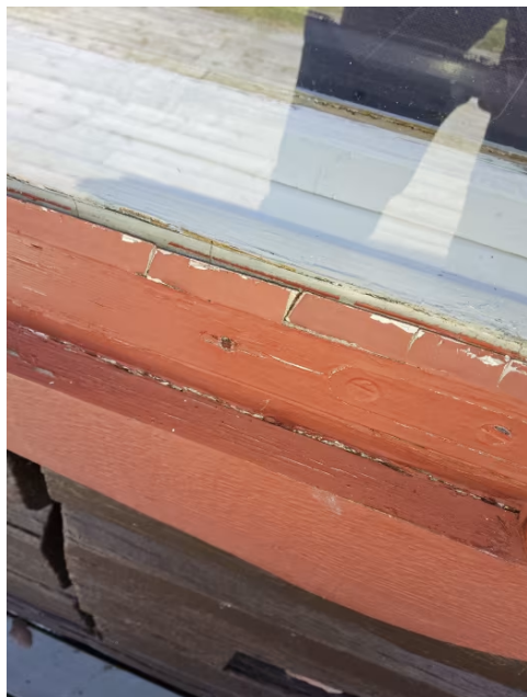
Bilde viser sprukket kittfals.
