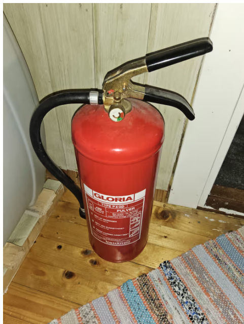
Bilde viser brannslukningsapparat.
