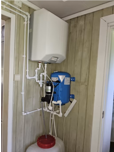
Bilde viser varmtvannsbereder.
