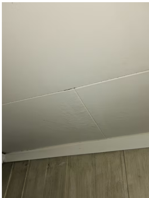
Bilde viser fuktskjold i himling.
