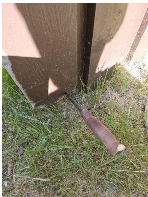
Bilde viser råteskadet trekledning.
