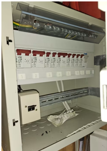
Bilde viser sikringsskap.
