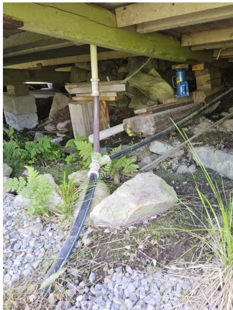
Bilde viser uisolerte avløpsrør.
