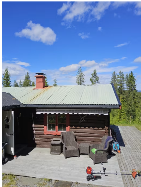
Bilde viser manglende takstige.
