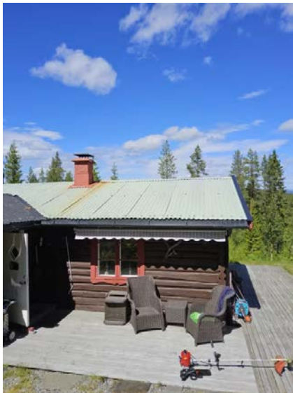
Bilde viser manglende takstige.
