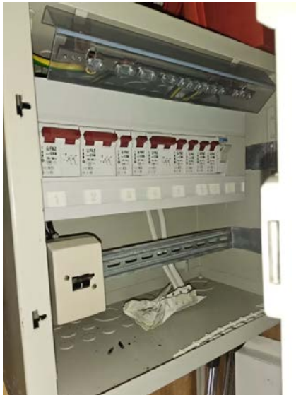
Bilde viser sikringsskap.
