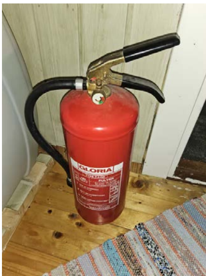
Bilde viser brannslukningsapparat.
