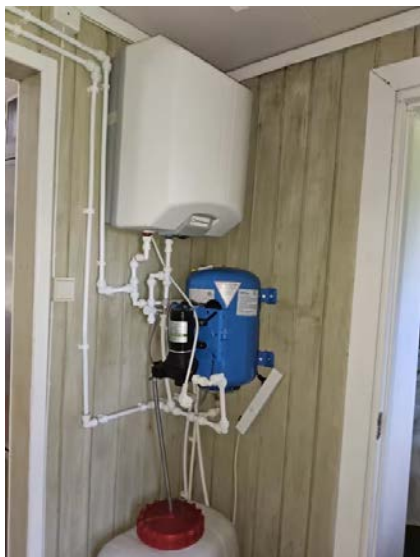
Bilde viser varmtvannsbereder.
