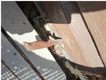
Bilde viser råteskade i bunnstokk.
