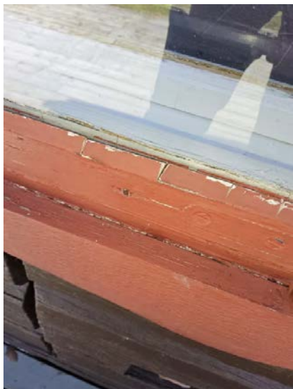
Bilde viser sprukket kittfals.
