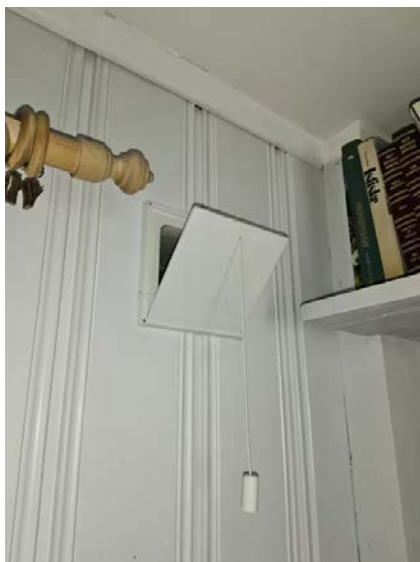
Bilde viser klaffventil på yttervegg.
