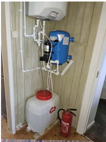
Bilde viser vanntank og vannpumpe.
