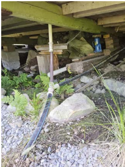
Bilde viser uisolerte avløpsrør.
