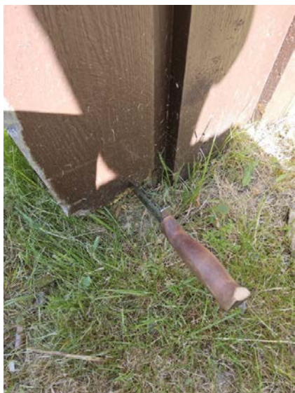
Bilde viser råteskadet trekledning.
