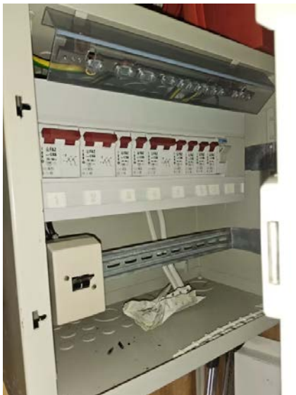
Bilde viser sikringsskap.
