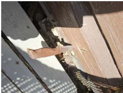
Bilde viser råteskade i bunnstokk.
