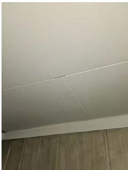
Bilde viser fuktskjold i himling.
