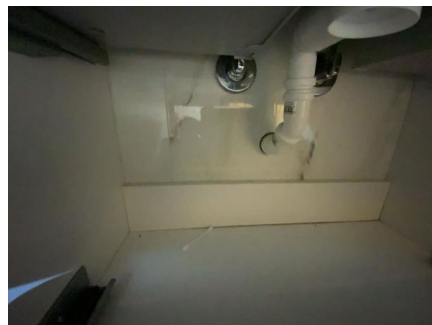
Det mangler tilstrekkelig tetting rundt avløpsrør.
