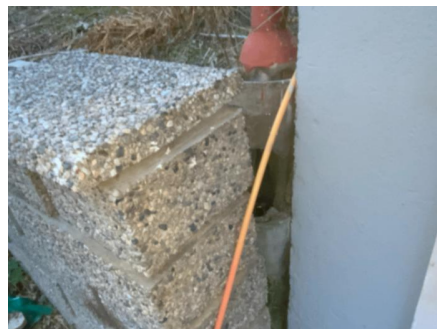
Lekkasje på nedløpsrør mot sørøst.
