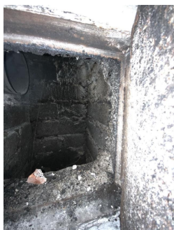
Slitte fuger og avskalling på innvendig pipeløp.
