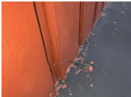
Råteskade på kledning mot sørøst.
