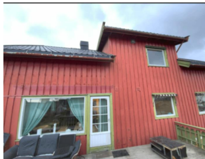
Kledning mot sørvest bærer preg av slitasje.
