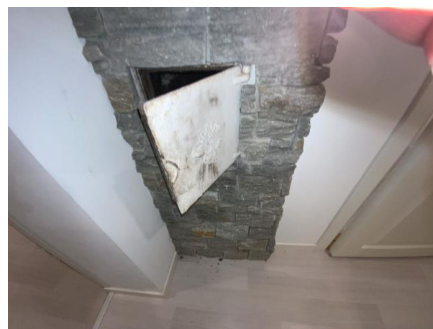
Feieluken kan ikke åpnes til full stilling.
