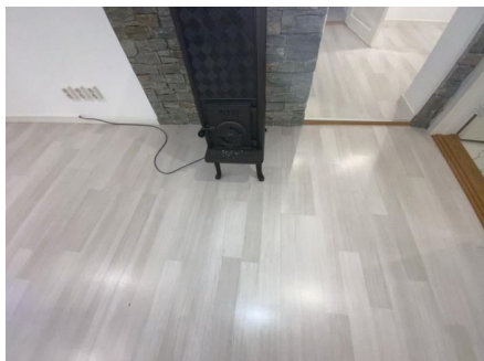
Mangler ildfast plate under/foran vedovn i kjeller.
