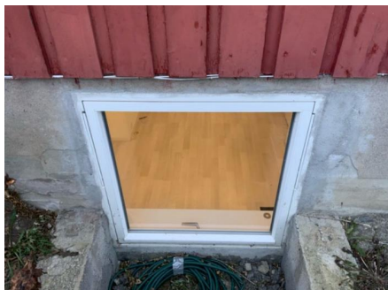
Kjellervinduene er ikke beskyttet mot fukt.
