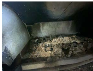
Det er en sprekk i den ildfaste steinen i vedovnen i 1. etasje.
