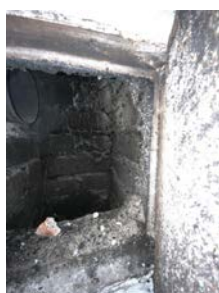
Slitte fuger og avskalling på innvendig pipeløp.
