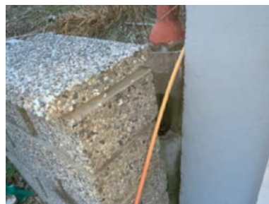
Lekkasje på nedløpsrør mot sørøst.
