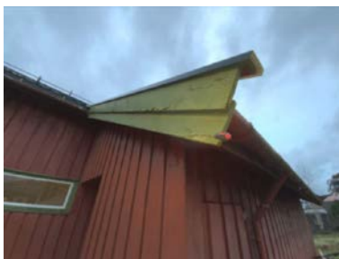
Værslitte vindskier og indikasjon på råte i treverk.
