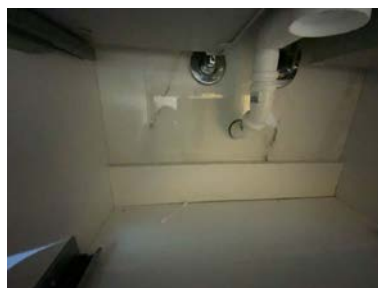
Det mangler tilstrekkelig tetting rundt avløpsrør.
