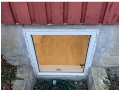
Kjellervinduene er ikke beskyttet mot fukt.
