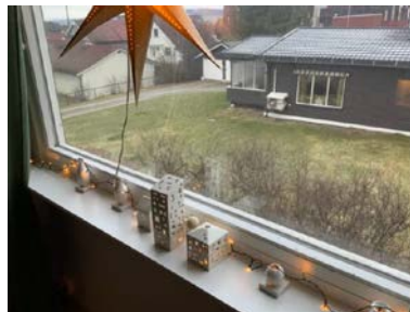
Vinduer i fra byggeår har brukt opp mye av sin forventet levetid.
