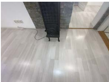
Mangler ildfast plate under/foran vedovnen i kjeller.
