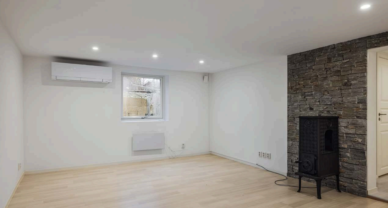
Stuen i kjelleren har både luft-til-luft varmepumpe, ildsted og panelovn.
