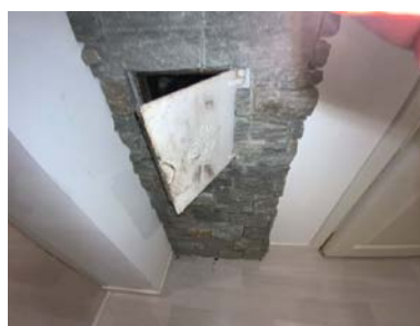
Feieluken kan ikke åpnes til full stilling.
