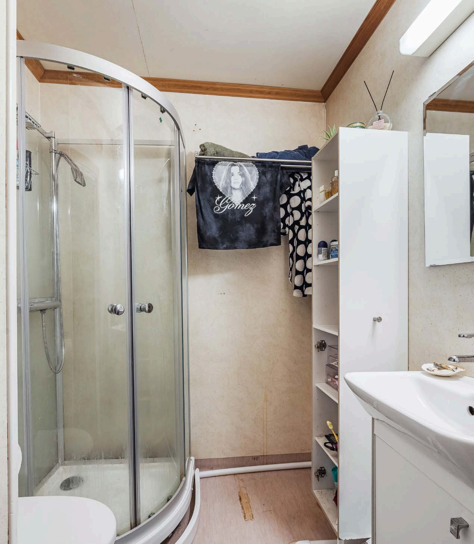
Eldre baderom med belegg på gulv og vegger. Baderommet har fått TG 3 og må oppgraderes for å tåle normal bruk etter dagens krav.
