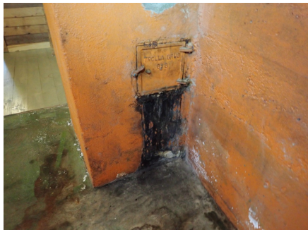
Beksot / sotvann under sotluke.
