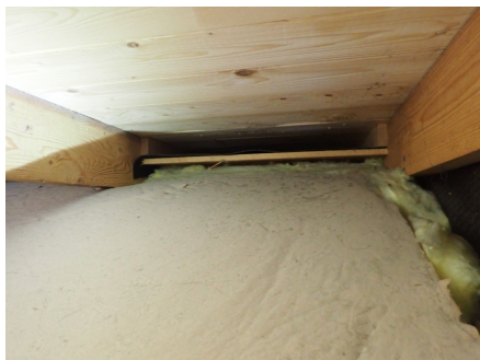
Synlig lufting ved raft.
