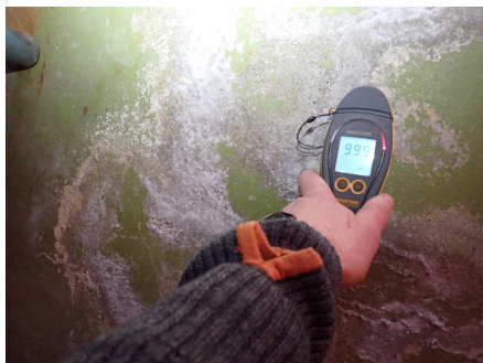
Mineralutslag på innside grunnmur.
