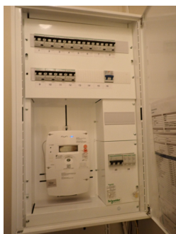
Sikringsskap med automatsikringer.
