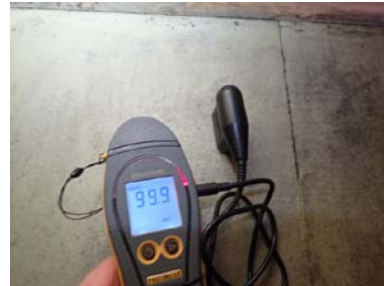
Sponplategulv mettet med fukt.
