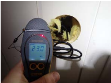
Det måles høy fuktighet i etasjeskille under bad ved sluk
