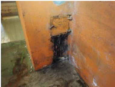
Beksot / sotvann under sotluke.
