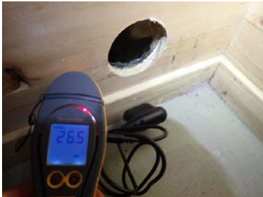
Det er våt isolasjon i hulltakingen, høyt fuktnnhold i panel og listverk.
