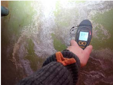
Mineralutslag på innside grunnmur.
