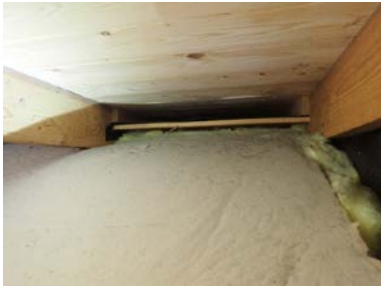
Synlig lufting ved raft.
