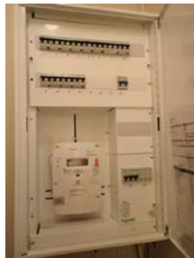
Sikringsskap med automatsikringer.
