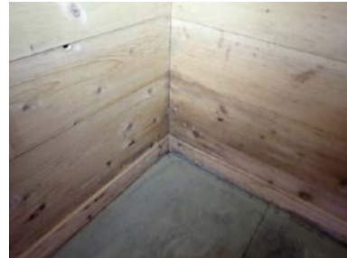
Svertesopp i innvendig panel.
