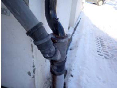
Utettheter i rørskjøter på nedløpsrør.
