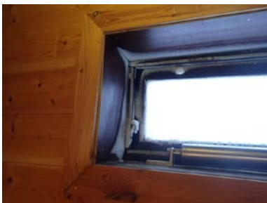
Is/rimdannelse i innvendige vindusbrett på vinduer i underetasjen.
