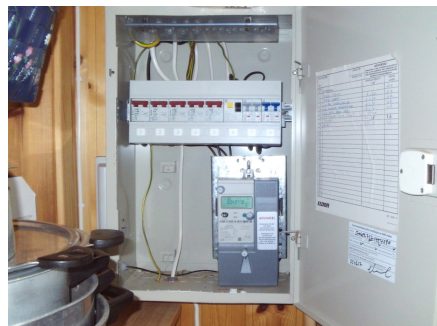
Sikringsskapet er plassert i bod.
