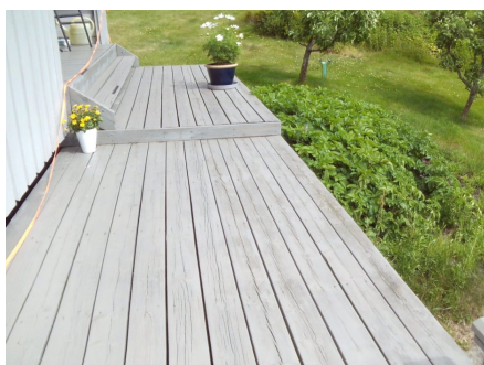
Ingen rekkverk på deler av terrassen
