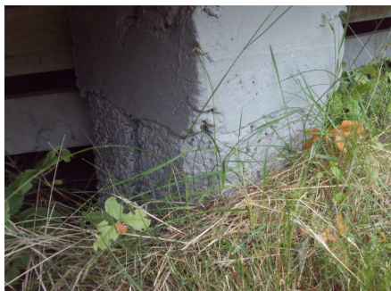
Ligger noe jordmasser inntil enkelte pilarer.
