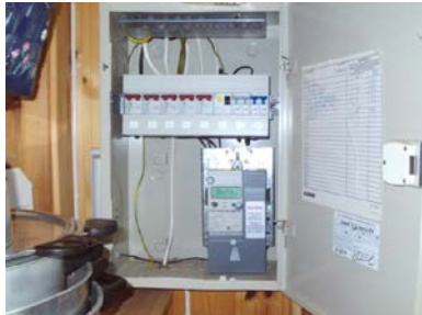
Sikringsskapet er plassert i bod.
