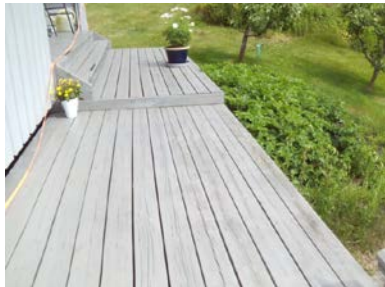
Ingen rekkverk på deler av terrassen
