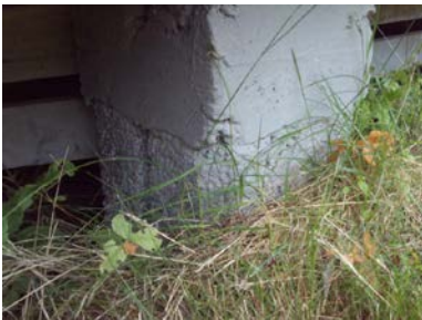
Ligger noe jordmasser inntil enkelte pilarer.
