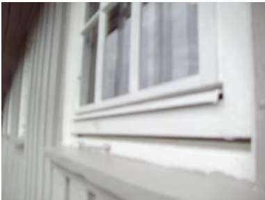
Noe slitt på utvendig karm og ramme.
