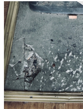
Skade på skiferplate under peisovn
