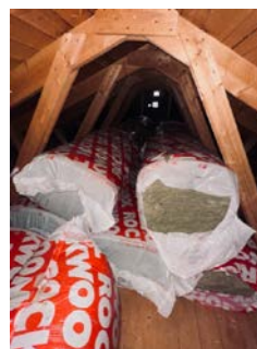
Mineralull til en evt etterisolering av loft.
