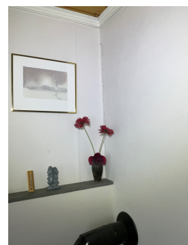
Sprekk i hjørne mellom pipe og brannmur
