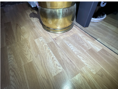
Fuktskade på laminatgulv
