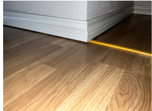
Stor glippe mellom gulv og gulvlist
