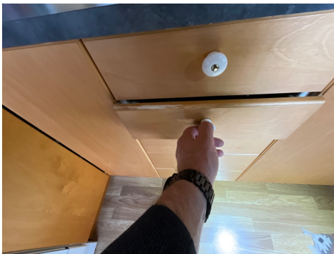
Noe økt slittasje på enkelte fronter
