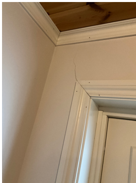
Sprekk i veggoverflate etter setning
