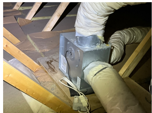
Tegn til kondensdannelse på viftemotor på loft
