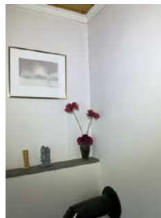
Sprekk i hjørne mellom pipe og brannmur
