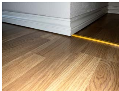
Stor glippe mellom gulv og gulvlist
