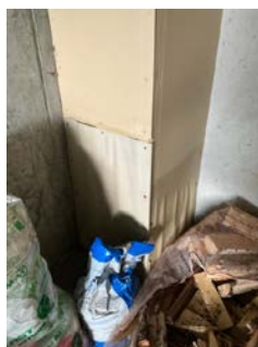
Tegn til noe fuktproblem på gipsplater i garasje
