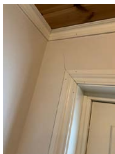
Sprekk i veggoverflate etter setning
