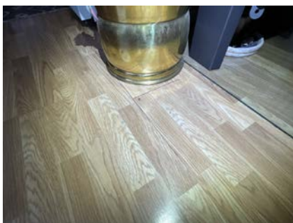
Fuktskade på laminatgulv
