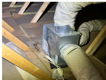
Tegn til kondensdannelse på viftemotor på loft
