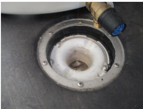
Sluk ved bereder.
